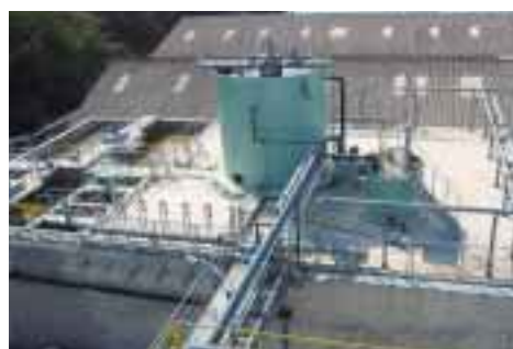
完成した新排水処理設備（岡山工場）
